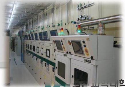
공정 Gas 공급 설비
