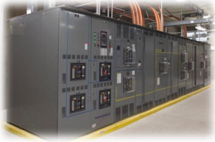
전기 공급 설비
